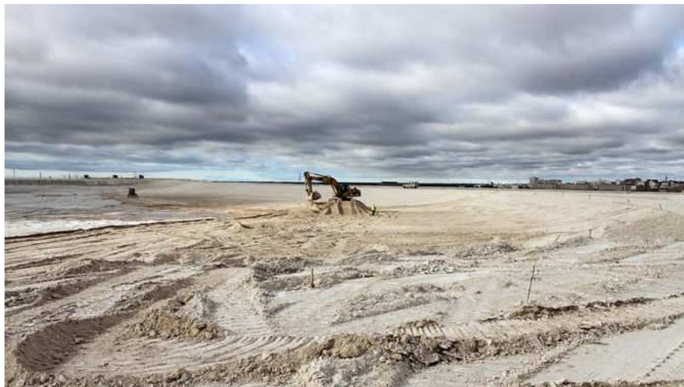
Imagen de archivo de una excavadora trabajando en la formación de taludes en una de las balsas activas. / ALBERTO DOMÍNGUEZ.
