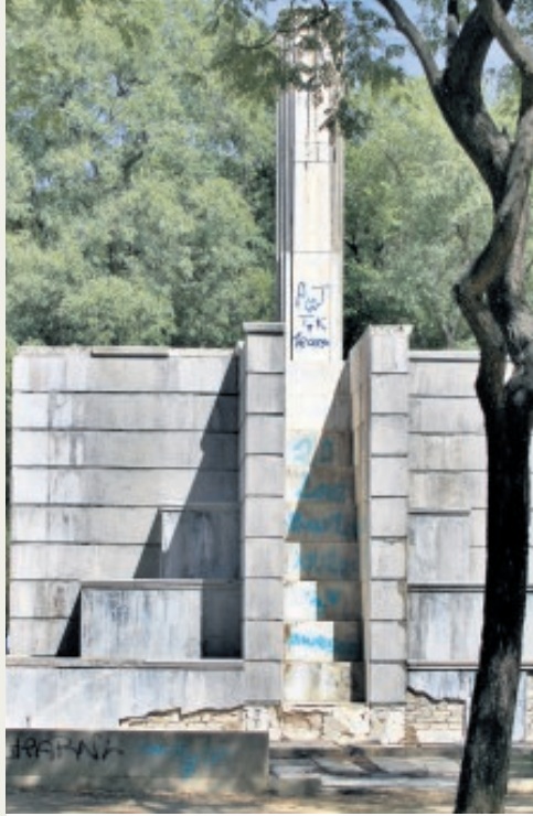
Sobre estas líneas, la fuente monumental en estado ruinoso. A la derecha, los hoyos del terreno y la sequedad de las zonas verdes.
